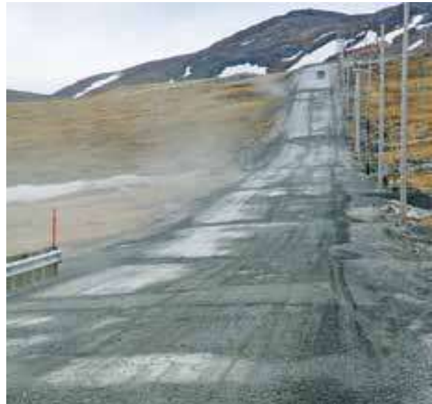
Figure 6. Route d'accès de l'aéroport de Salluit montrant d'importantes déformations avec une succession de tassements dus au dégel (refaite à neuf à l'été 2012).
